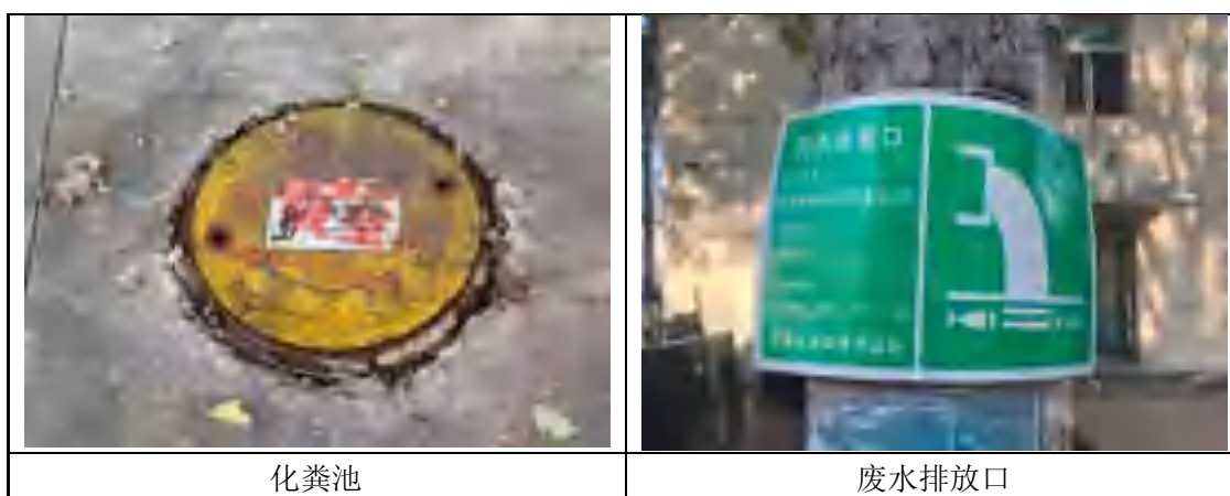
图 4.1-4 化粪池及废水排放口
