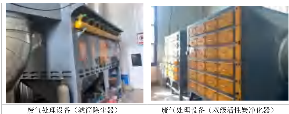
图 4.1-1 废气收集、处理装置及排气筒
