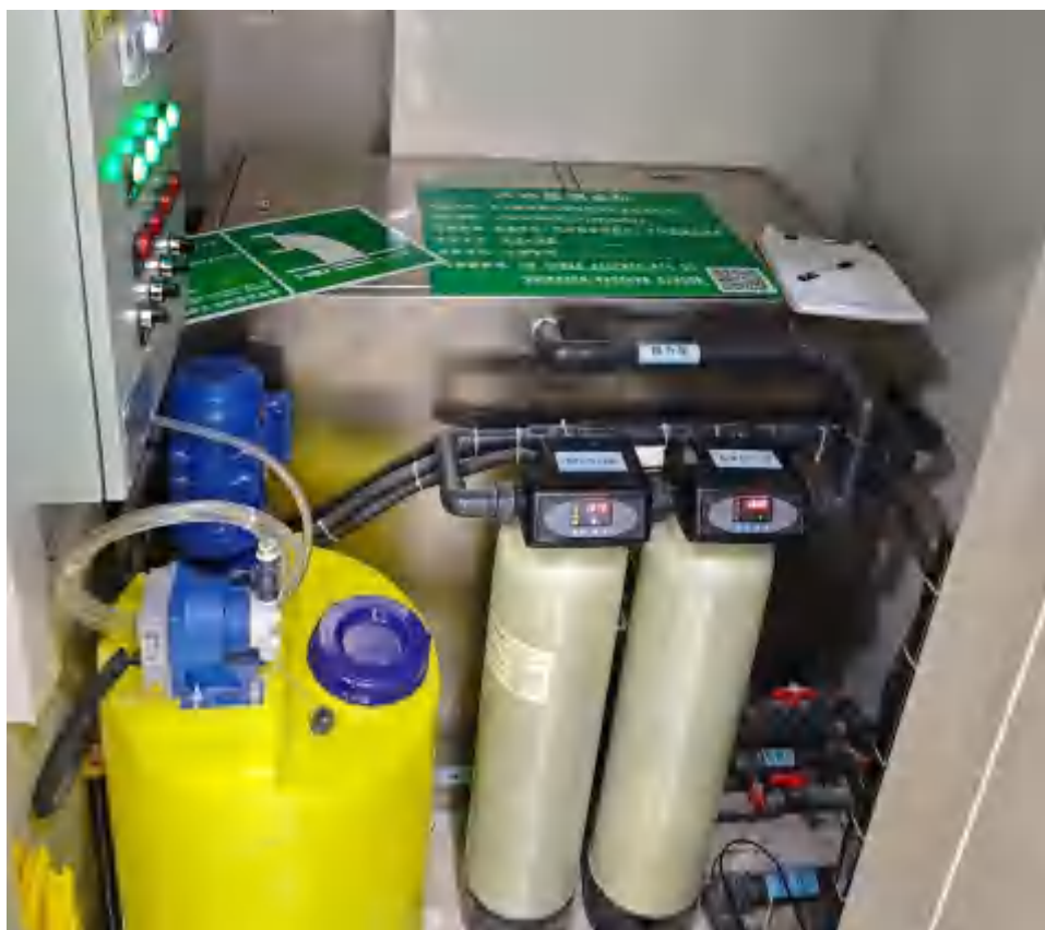
图 4-2 项目废水净化设施
